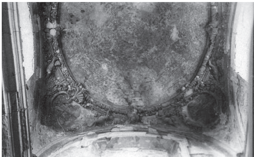
8. Warszawa, kościół paulinów. Sklepienie prezbiterium, fot. 1945 r. (po spaleniu kościoła)
