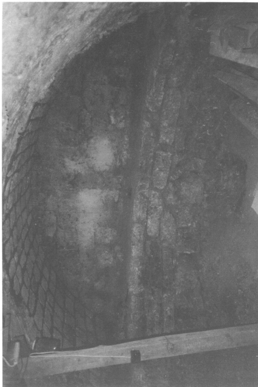
8. Zawichost. Kościół parafialny – krypta, odsonięte relikty apsydy wschodniej, sklepienie nowożytnie, uzupełnione. Fot. W. Koziejowski, 1993.
