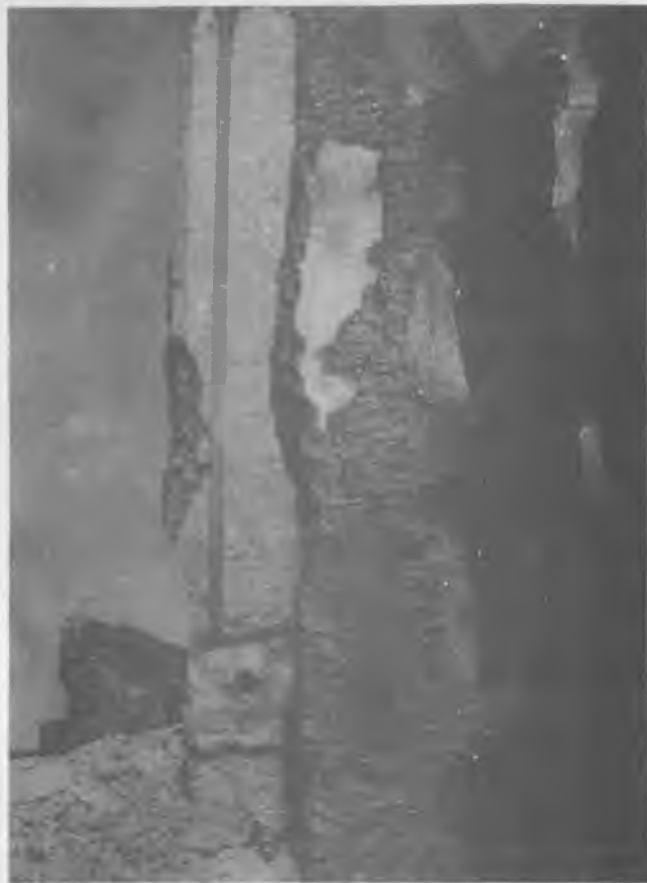
19. Relikt ściany frontowej katedry św. Jana z widoczną licówką z okresu prac Kudera (1903 r.) oraz ruina dzwonnicy z XVI w. Stan z 1947 r. Fot. autor
