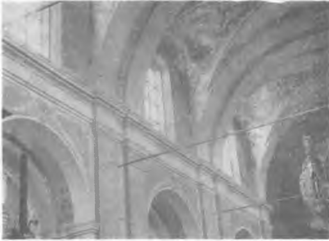
Ryc. 6. Kościół w Krośnicach. Sklepienie nawy głównej. Zbiory AKBO
